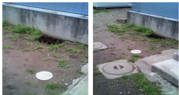
写真-2 陥没状況
